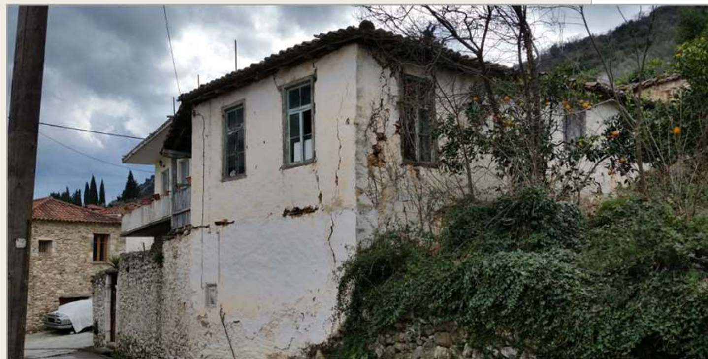
Εικ.Π.50-02: Στο κτίριο αυτό στη πρόσοψη υπάρχουν μόνο δύο παράθυρα. Η χρήση ξυλοδεσιών, στα ανοίγματα και στους τοίχους ανάγουν τη κατασκευή του στο 19 ο αιώνα
